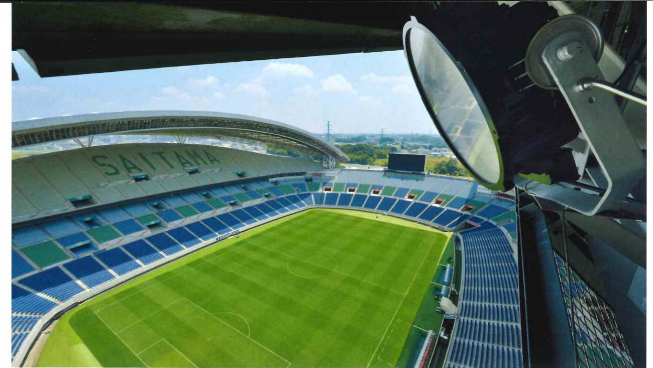
観客席を照らす「レディオック フラッド デュエル」は高さ約50mのキャットウォークに設置されている。 The LEDioc FLOOD DUELL lights illuminating the spectator seating are installed on catwalks about 50m high.
