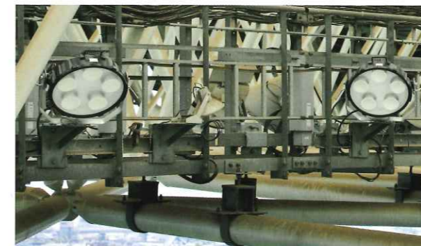
「レディオック フラッド デュエル」設置状況。 The installed LEDioc FLOOD DUELL lights.
